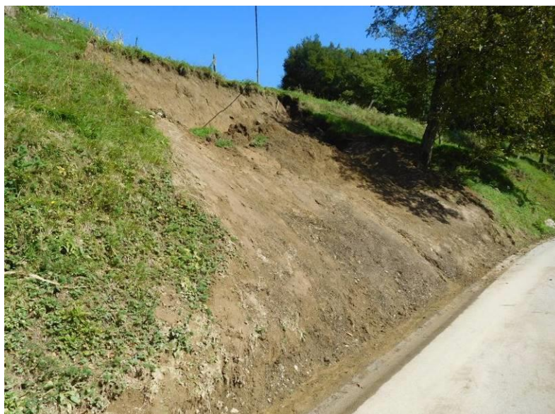
poškodbe na brežini nad LC 490202
