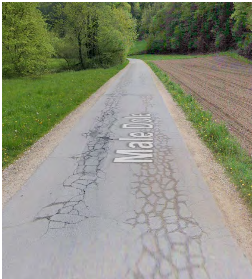
Slika 2: Del poškodovanega vozišča
