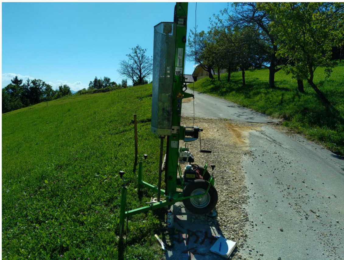
Slika 3-fotografija večjih razpok na cesti
