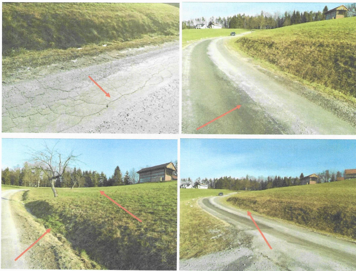
Razpoke na cestišču, narivi na cestišču, lokalno zasut jarek, nagubano pobočje, poševno rastoče drevje
