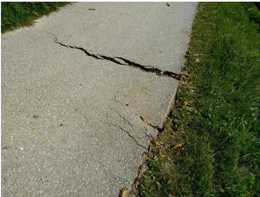
Slika 3 - Predmetna cesta, plaz
