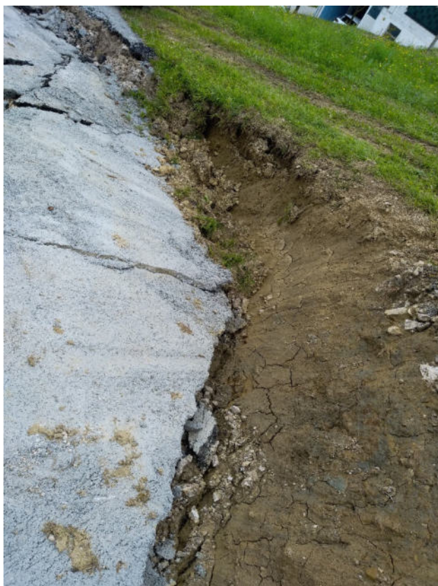
Slika 5 - Predmetna cesta, plaz
