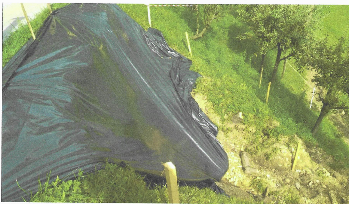
Slika 2 – fotografija plazu pod cesto
