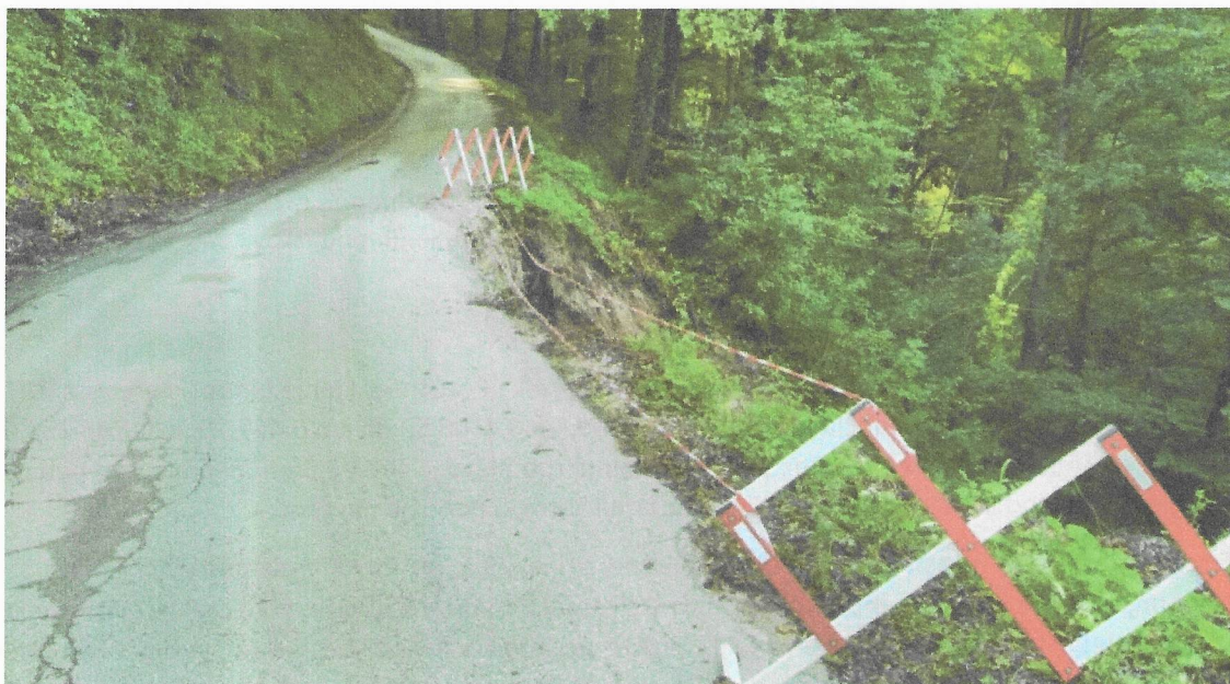
Slika 2 – fotografija plazu pod cesto
