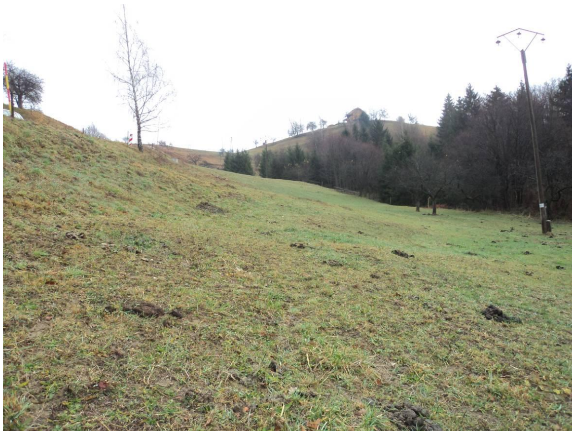
Nariv zemeljskih mas na brežini pod cesto
