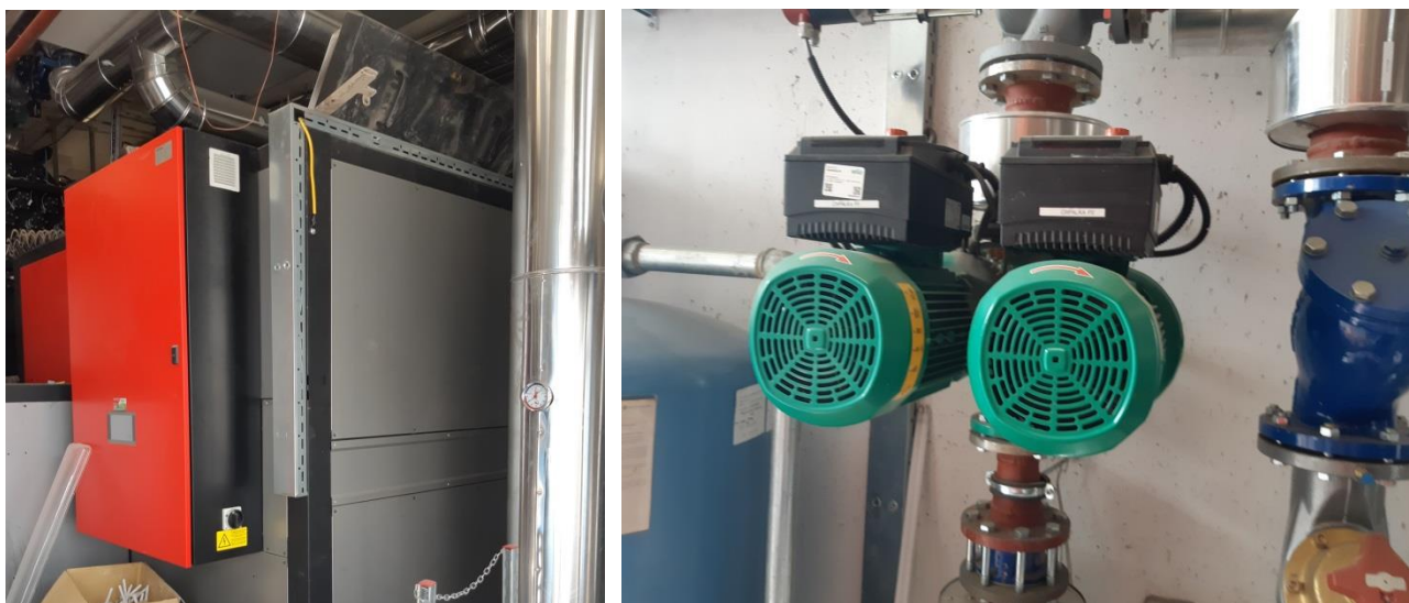
Slika 2: Posnetek del razdelilnika in kotla na biomaso
