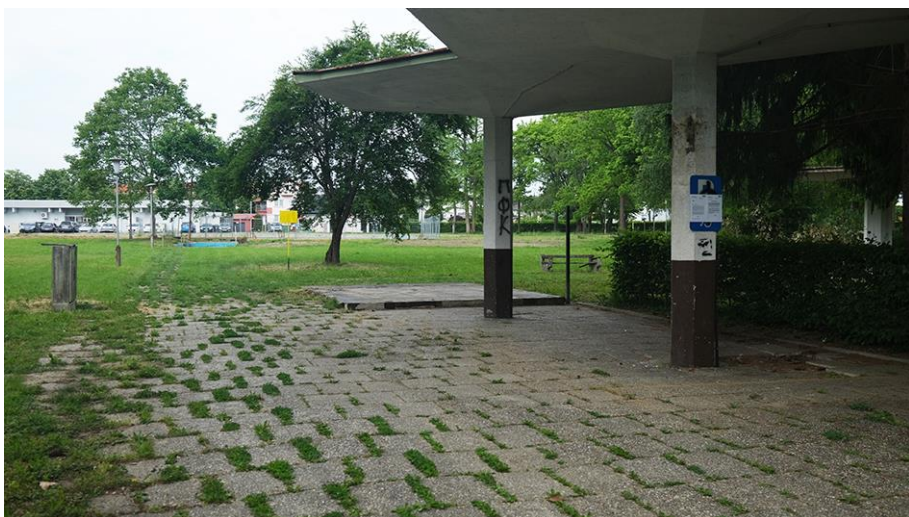
Slika 26: Dotrajani paviljoni in značilni betonski tlak na območju kopališča
