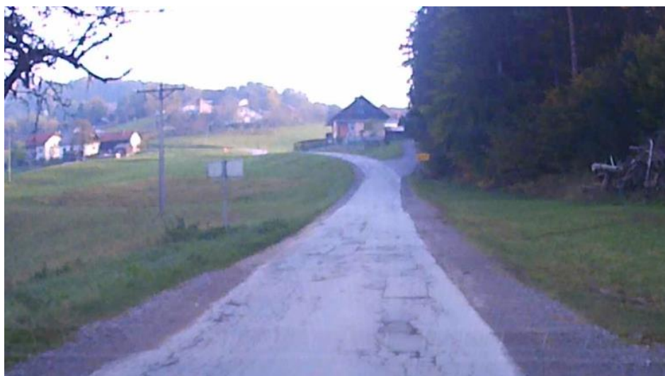
Slika 2: Pogled na razpokano in krpano vozišče, pogled v smeri stacionaže.
