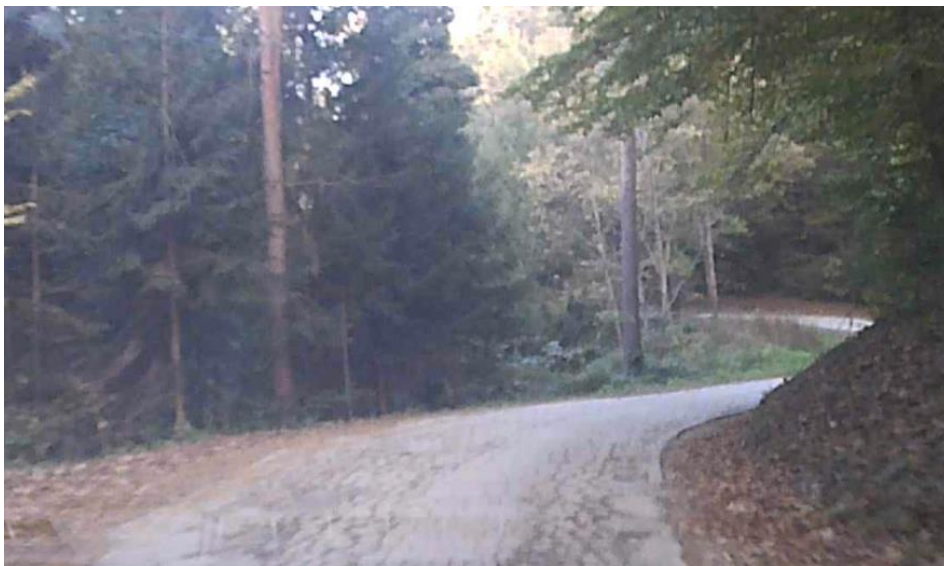
Slika 3: Pogled na mrežasto razpokan asfalt v gozdu, pogled v smeri stacionaže.
