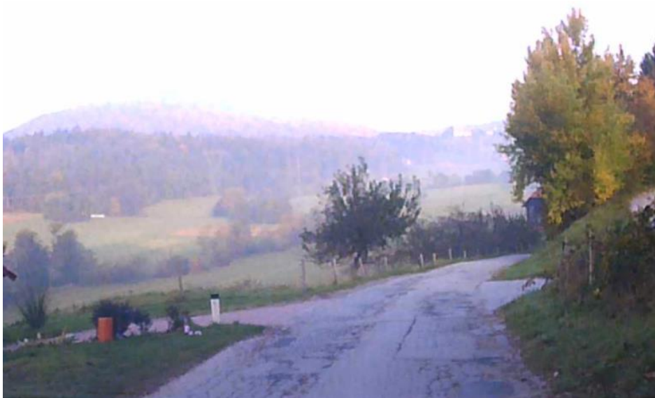
Slika 5: Pogled poškodovan asfalt na hišnih priključkih, pogled v smeri stacionaže.
