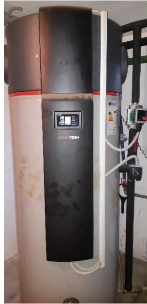
Slika 4: Toplotna črpalka za pripravo TSV
