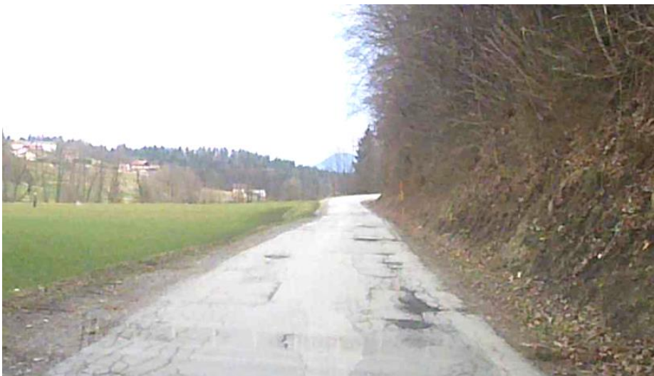
Slika 3: Pogled na vkopni del s potekom ob gozdu z vidnim uničenim voziščem.
