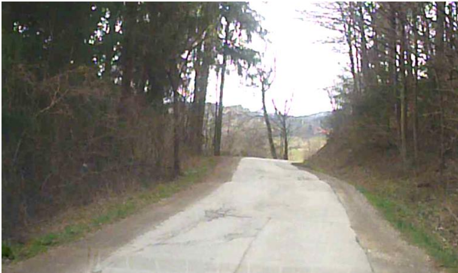
Slika 2: Pogled na prvi usedek roba vozišča vključno z dotrajanim voziščem.
