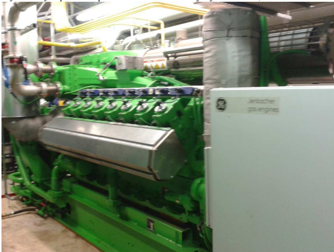
Slika 28: Kogeneracijsko postrojenje daljinskega ogrevanja Bled (vir: Petrol)
