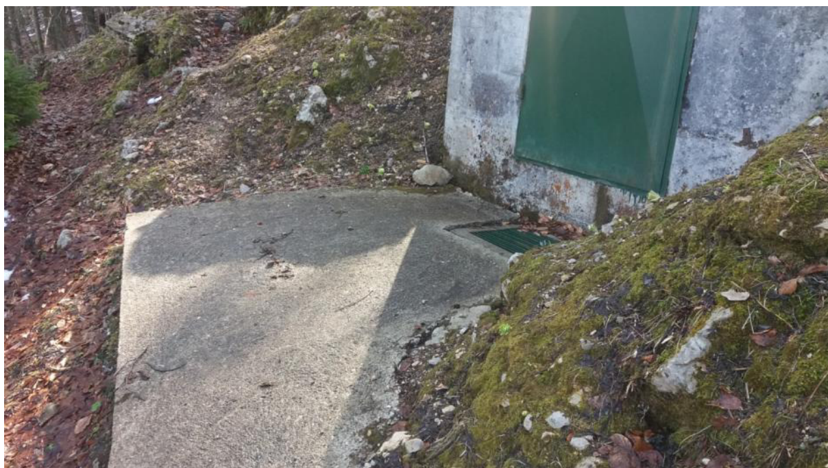
Slika 8: Betonska plošča pred rezervoarjem je položena na pobočni grušč in je nekoliko premaknjena zaradi posedka
