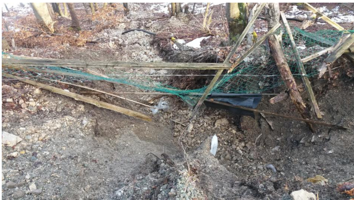
Slika 6: Erozijska poškodba pod rezervoarjem je posledica vodne erozije ob visokih vodah. Nujno jo potrebno zapreti s prečnim jezom 'kamen-beton' dolžine 5 m in višine 3 m. V primeru trajne sanacije se navzdol po grapi uredi kamnit kanal za odvajanje padavinske vode
