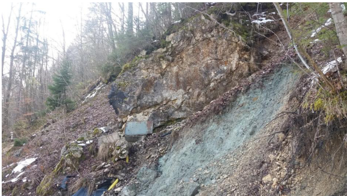
Slika 3: Pogled od strani na skalni blok, pod njim je poškodovano vodno zajetje
