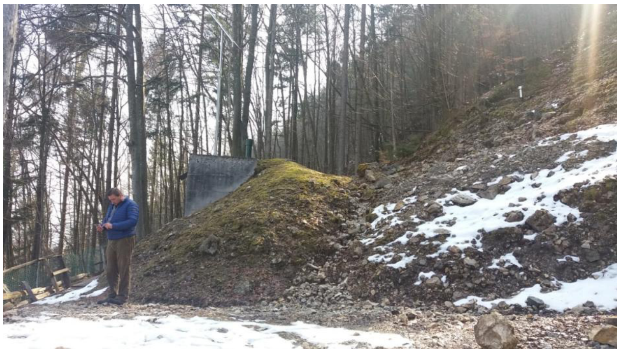
Slika 5: Vodni rezervoar je zasut z gruščem
