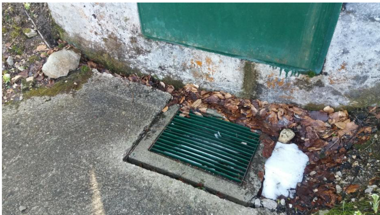
Slika 9: Odprte razpoke med pohodno ploščo pred rezervoarjem in sprednjo steno rezervoarja
