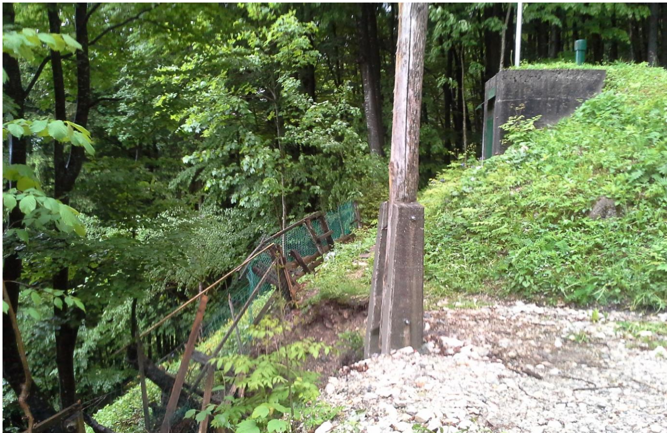
Slika 2: Pogled na erodirano brežino pod električnim drogom in vodovodnim zajetjem
