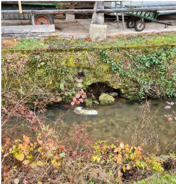
Slika 6: Dotrajani in poškodovani zidovi ob Rečici
