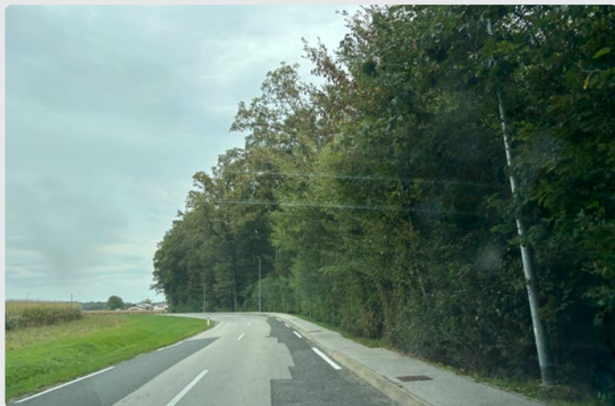
Slika 50: Dotrajano vozišče državne ceste RT-941/1541 Grabonoš–Radenci, brez površin namenjenih kolesarjem
