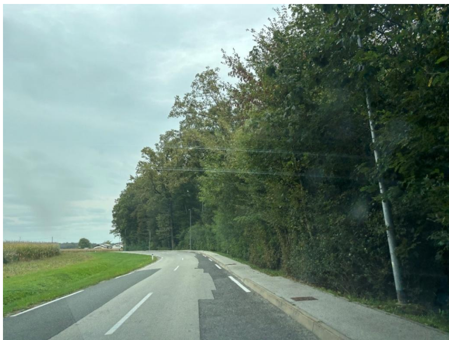
Slika 49: Dotrajano vozišče državne ceste RT-941/1541 Grabonoš-Radenci, brez površin namenjenih kolesarjem
