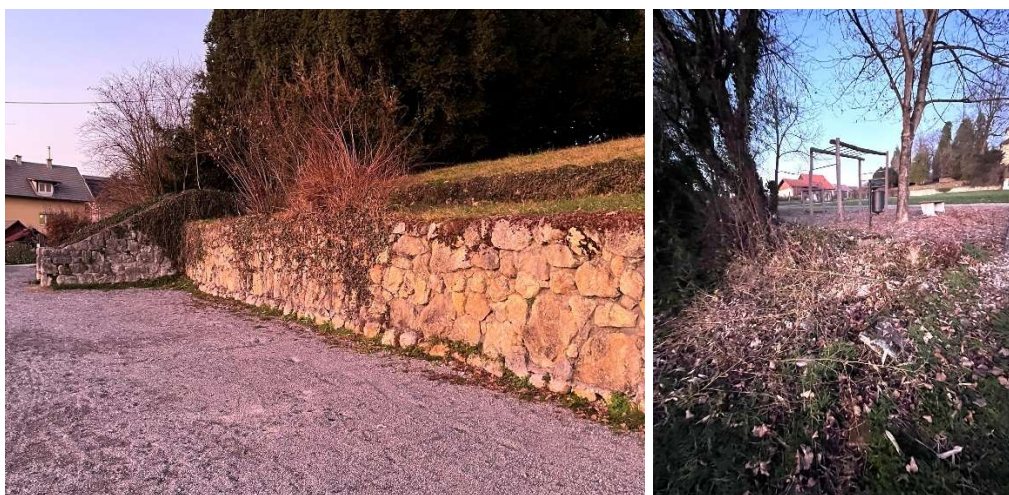
Slika 10 in Slika 11: pogled na ohranjen in saniran zid (levo) in napol porušen in zaraščen zid (desno).
