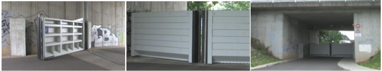
slika 19: avtomatična protipoplavna vrata
