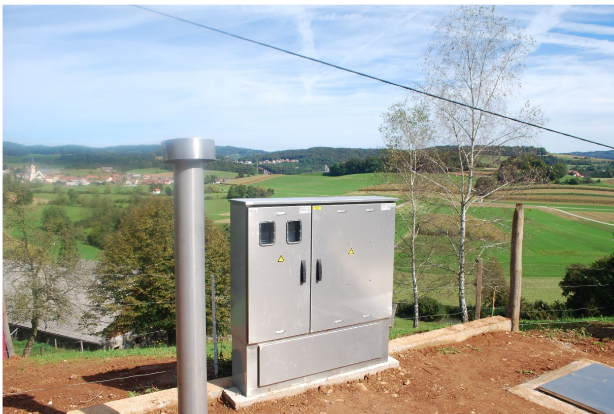
Fotografija : črpališče pod Golobinjekom
