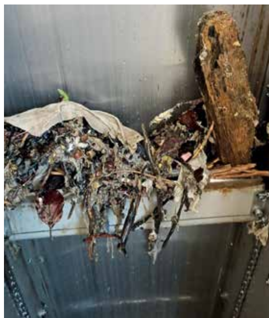
Okvara grobih grabelj zaradi večji odpadkov, npr. kosi lesa ipd.
