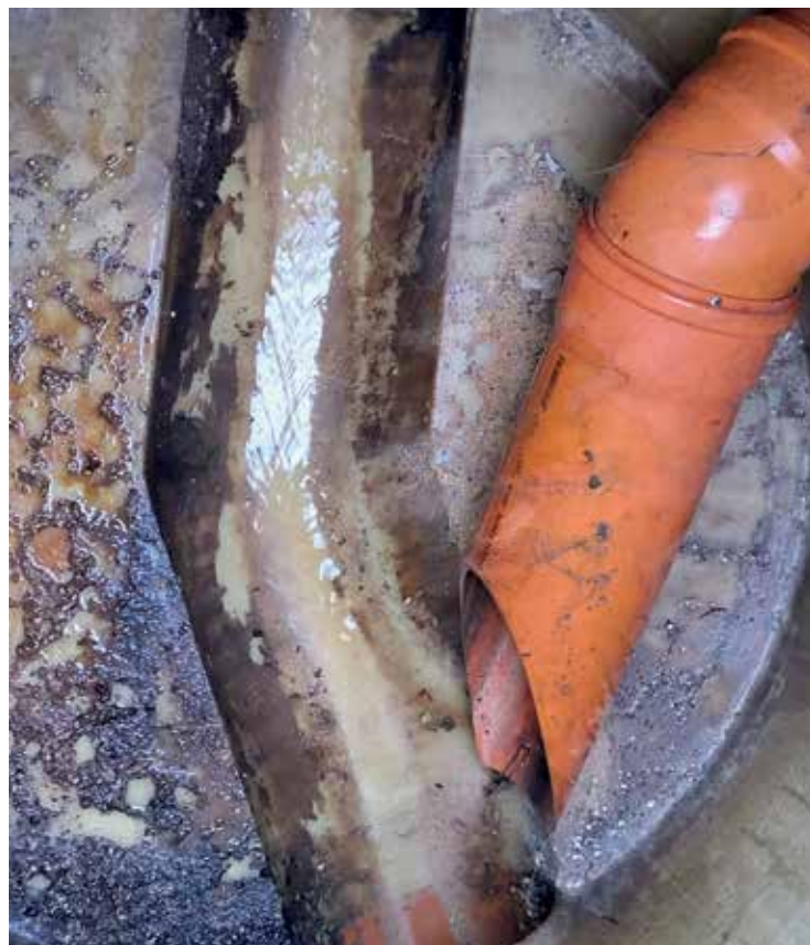
Vdor podtalnice v kanalizacijo
