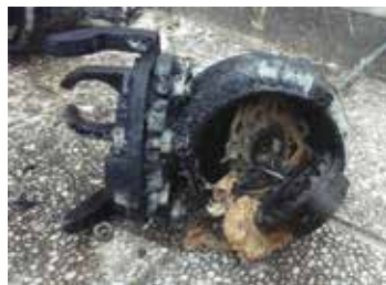
Zamašena črpalka v kanalizacijskem črpališču Brest 2
