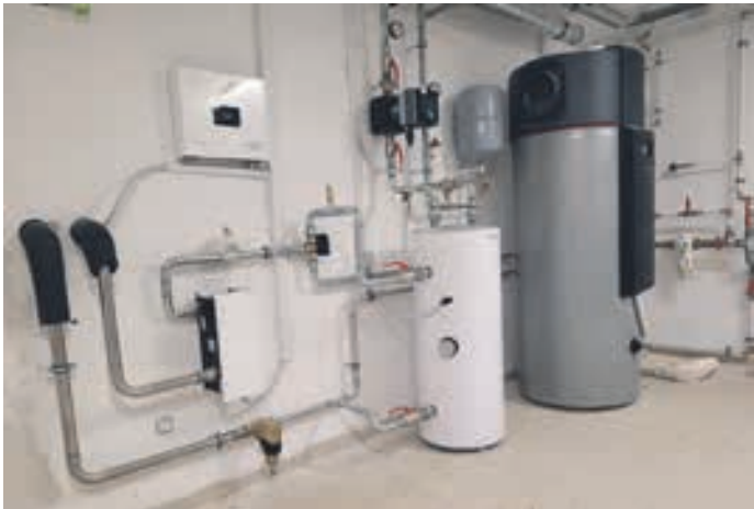
Kotlovnica z vso naj sodobnejšo opremo.
