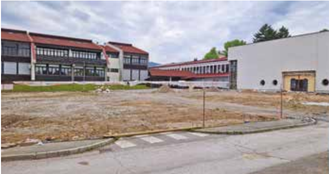
Dela na delovišču trenutno stojijo zaradi potrebe po novem projektu za temeljenje. Izkazalo se je namreč, da tla niso take sestave, kot je bilo prvotno načrtovano.
