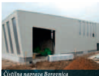
Čistilna naprava Borovnica
