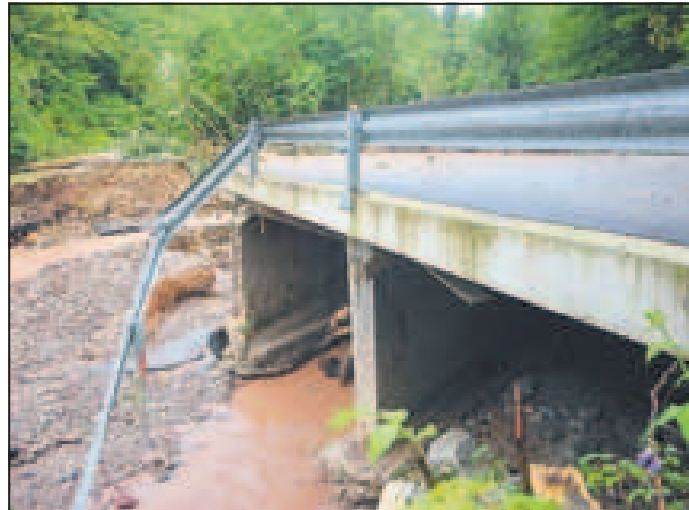
Petačev graben – most je voda zaobšla, saj je zamašen z drevjem in vejevjem!
