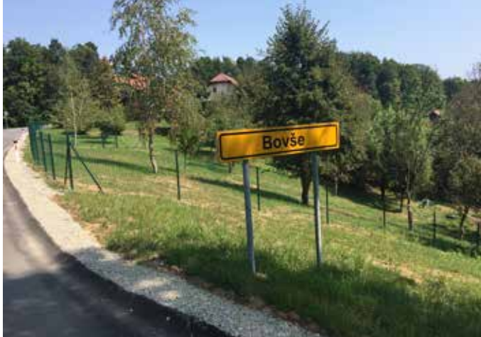
V Bovšah je plaz ogrožal cesto.
