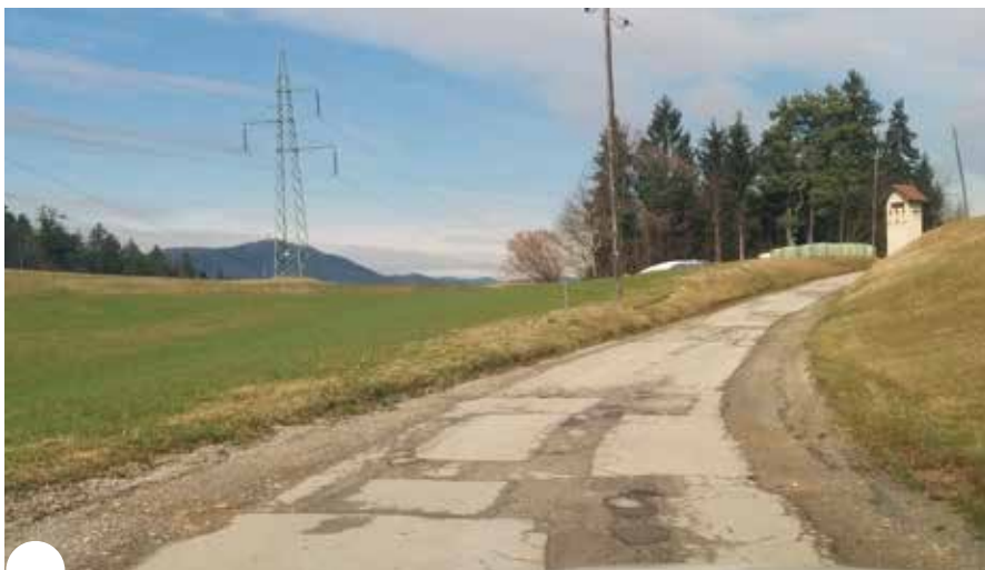
Lokalna cesta LC 490-370 (Založe-Podsevčnik)
