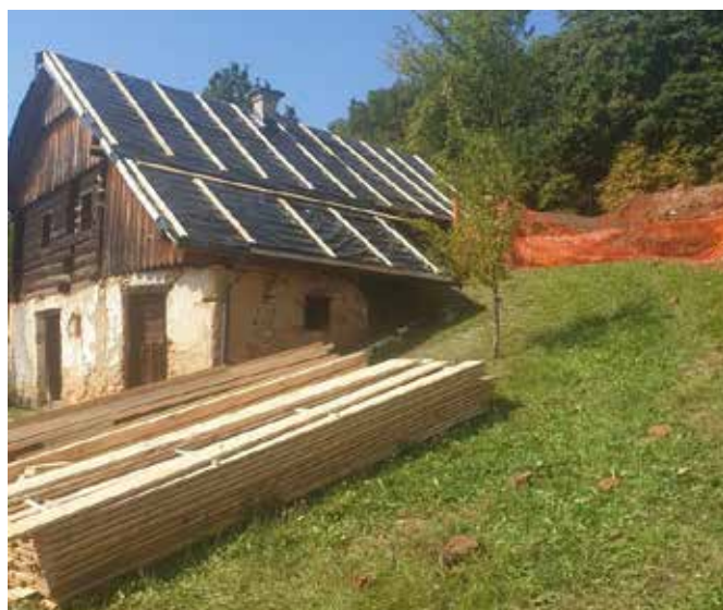
Zaradi dotrajanosti objekta bo obnova zelo zahtevna.
