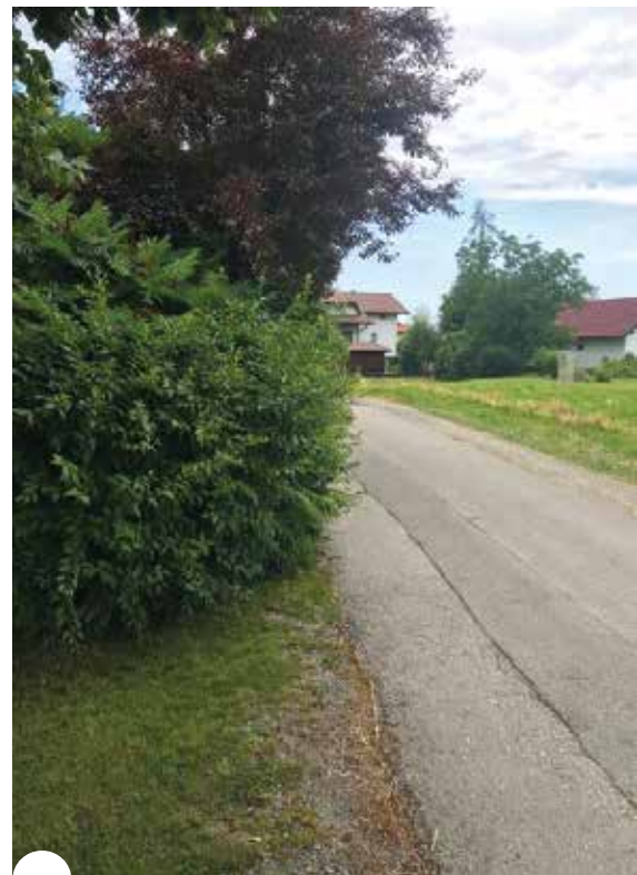
Razraščena vegetacija se zarašča v cestno telo in ovira preglednost.
