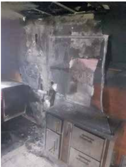
Požar je povsem uničil bivanjske prostore v hiši Janeza Tajnška iz Andraža nad Polzelo. Zgorela je vsa oprema in inventar.
