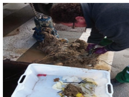
Odstranjevanje vlažilnih robčkov, higijenskih vložkov in plen iz kanalizacije
