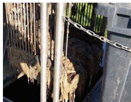
Čistilna naprava Apače
