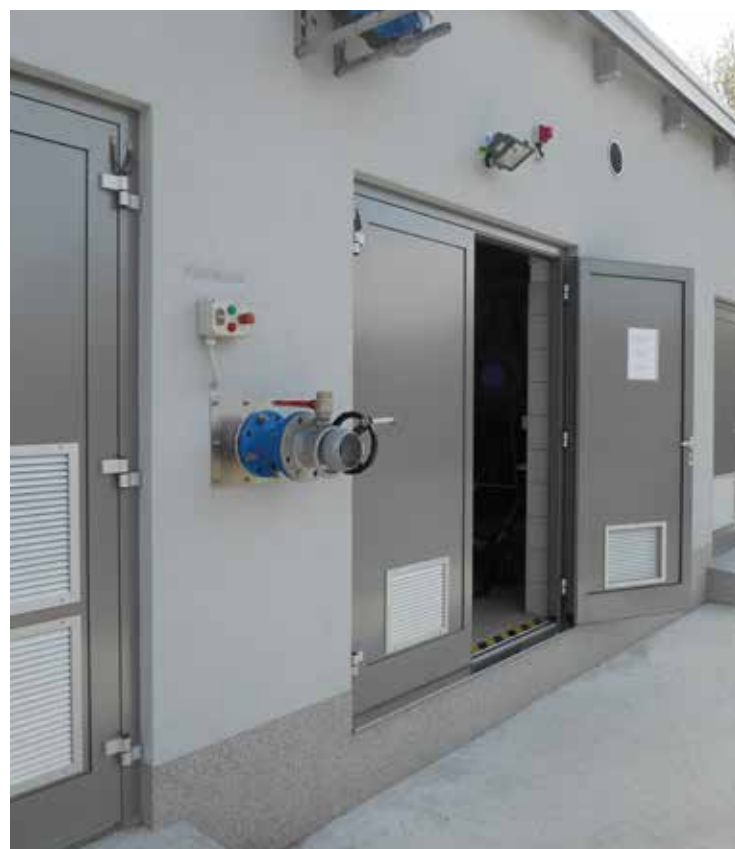
Priključek za cisterno za sprejem blata iz greznice
