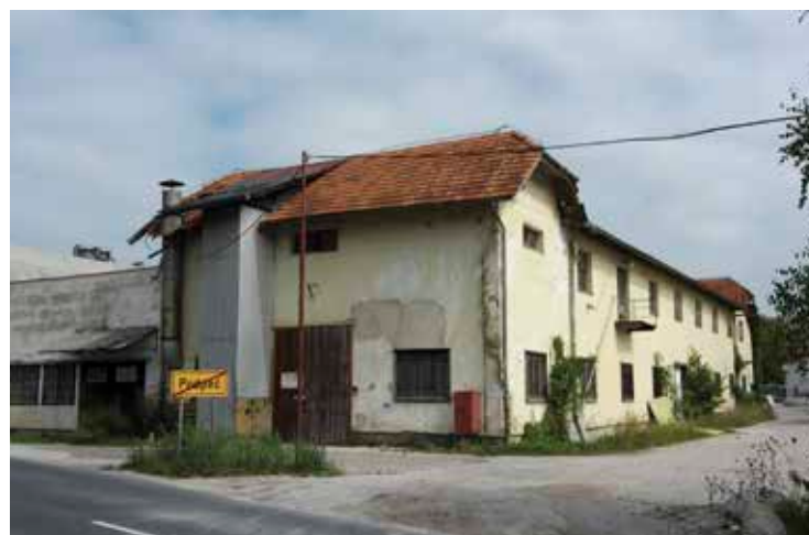
Zgradbe na prvi pogled zgledajo solidno, vendar podrobnejši ogled pokaže drugačno sliko razpadajočih lesenih objektov.
