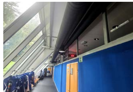
Prenovljen prezračevalni sistem v Ledeni dvorani Bled, foto: Občina Bled
