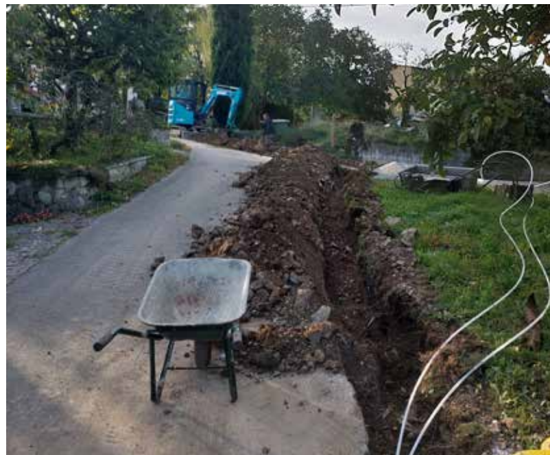
Optično omrežje se gradi tudi po dolini in po Vipavskih gričih, GVO je že v Tevčah.
