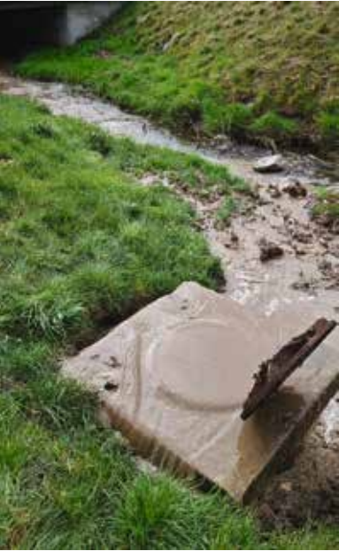
Prelivanje fekalne kanalizacije zaradi zamašitve sistema
