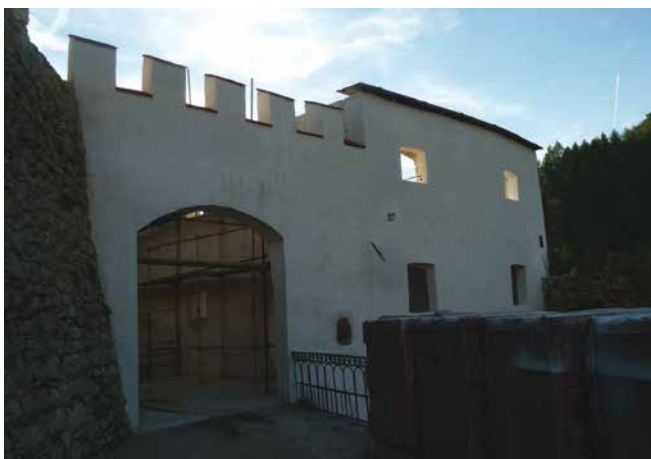
Zid nad kletmi, ki so bile med prvimi obnovljene.
