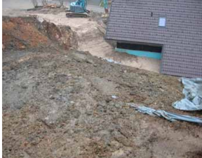
Primer splazitve zaradi prestrme vkopne brežine
